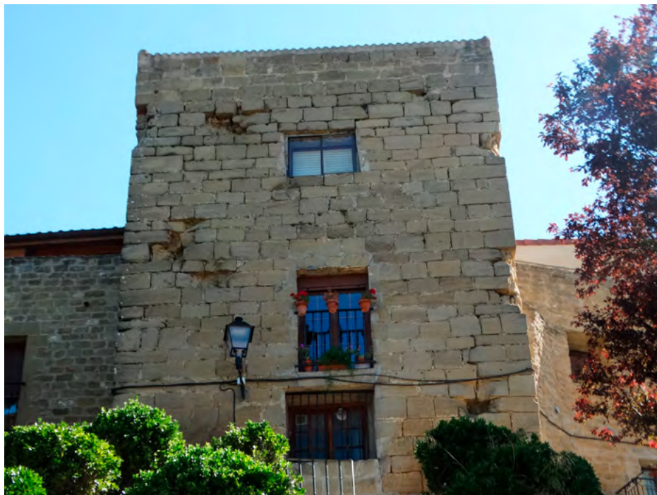
Figura 6. Torre de la muralla liberal de Laguardia donde se observan los impactos de artillería liberales
