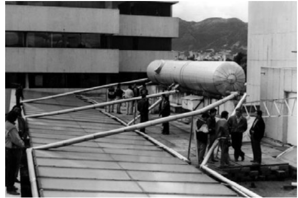
Figura 2. Calentador de la cafetería de la antigua Empresa de Energía de Bogotá (EEB). Construido en 1983 por el Centro Las Gaviotas (140 m 2 de colectores, tanque de 12 000 litros) y desde entonces en operación. Estudios previos para la EEB por la Universidad Nacional de Colombia.
