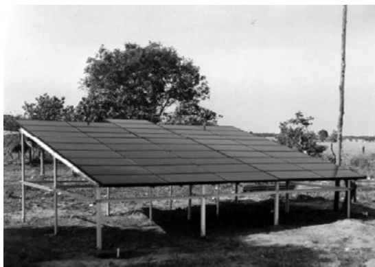
Figura 4. Sistema solar de 2.8 kWp instalado por el antiguo ICEL (Instituto Colombiano de Energía Eléctrica, hoy IPSE) en la Venturosa, Vichada, en 1996. Suministra energía a 120 V AC a una comunidad de 12 familias y centro escolar.
