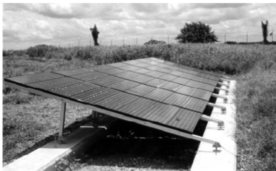
Figura 5. Sistema fotovoltaico de 3.4 kWp del Oleoducto Caño Limón-Coveñas. En operación desde hace más de 20 años.
