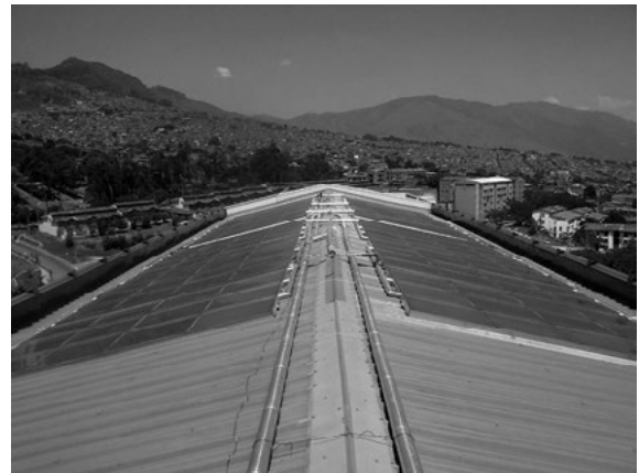
Figura 3. Colectores solares del Hospital Pablo Tobón Uribe, Medellín, en operación desde mediados de los ochenta (240 m 2 de colectores, tanque de 20 m 3 , no visible).
